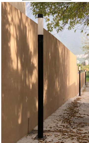
POSTE SIN GUARDA
