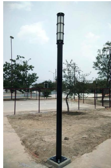
POSTE CON GUARDA
